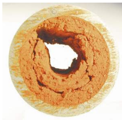
Abb. 6: Zugesehtes Abwasserrohr einer Poliermaschine nach versuchter Hochdruckreinigung
